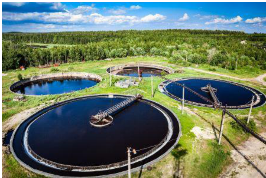
Figure 12 : Vue d'une station d'épuration de boues urbaines
