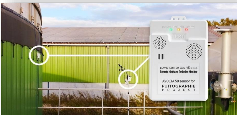
Détecteurs de gaz naturel Avolta 50 installés sur le site de Chand'Énergie (Ain) sur une cuve de stockage de digestat liquide © eLichens, 2024
